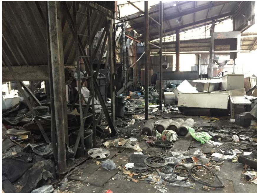
地震発生後の工場内部事例
